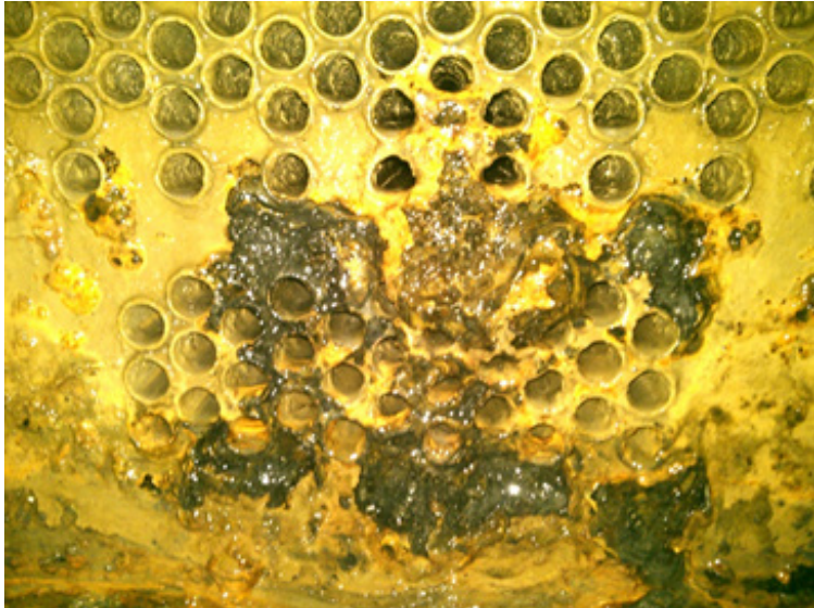
TUBOS DEL CONDESADOR
